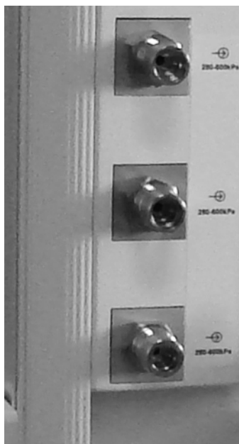
Рисунок 8-13: Входы труб централизованной системы подачи газа
